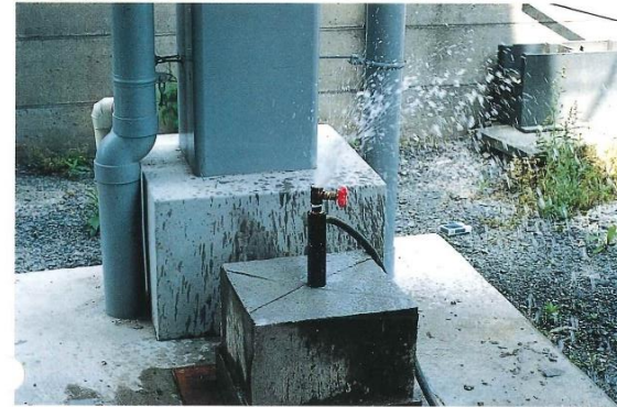
④上部コンクリート打設11日後、水道水をゴムホースで直接注水する。 水道水圧 2.5kg/cm 2 (水深25m) 0.245Mpa エア抜きをバルブより抜き、バルブをしめる。 水道栓は全開にする。
